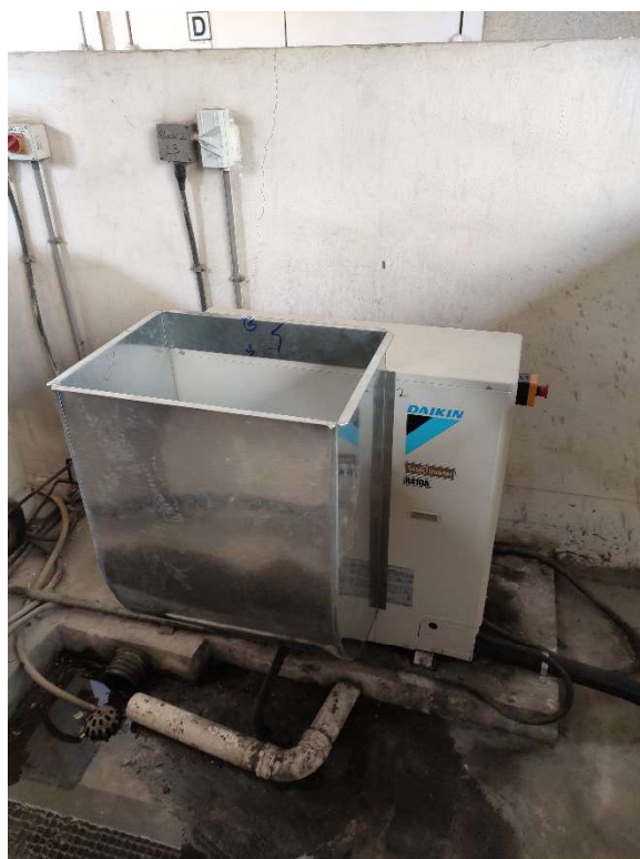
安裝後室外機
