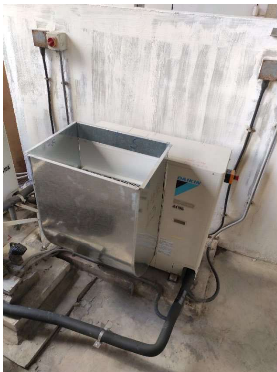
安裝後室外機
