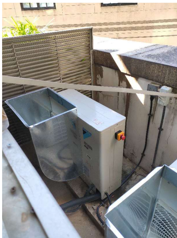
安裝後室外機
