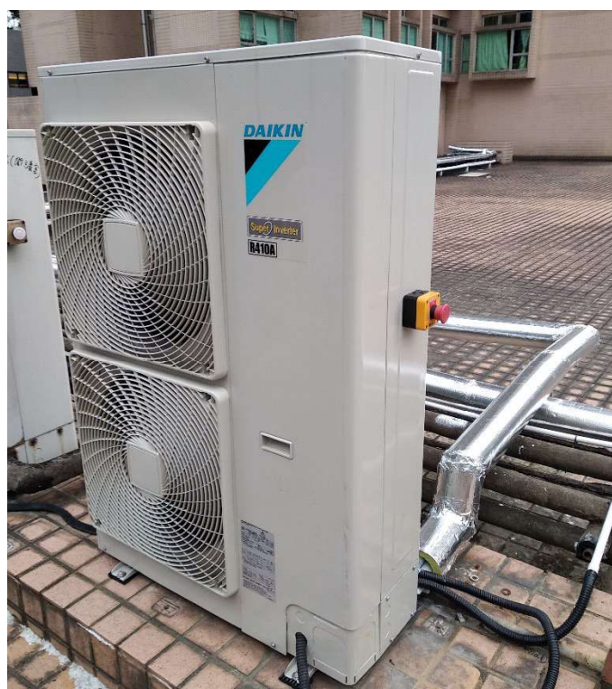
安裝後室外機
