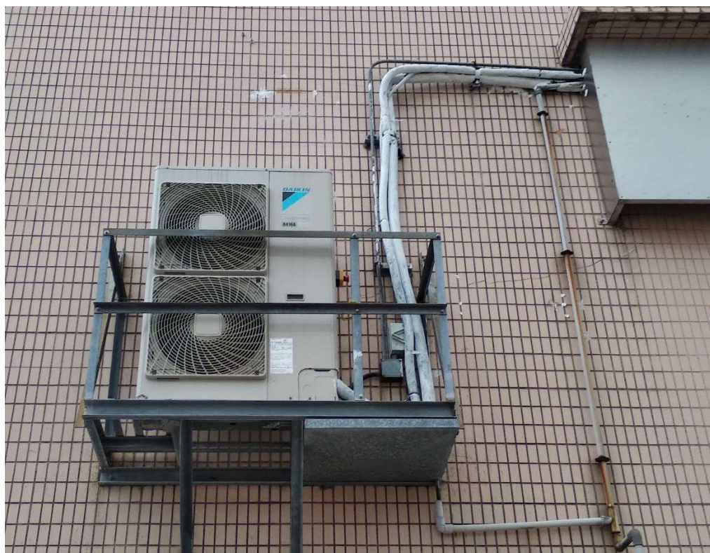
安裝後室外機
