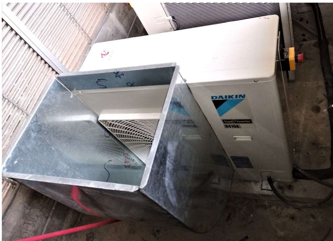
安裝後室外機
