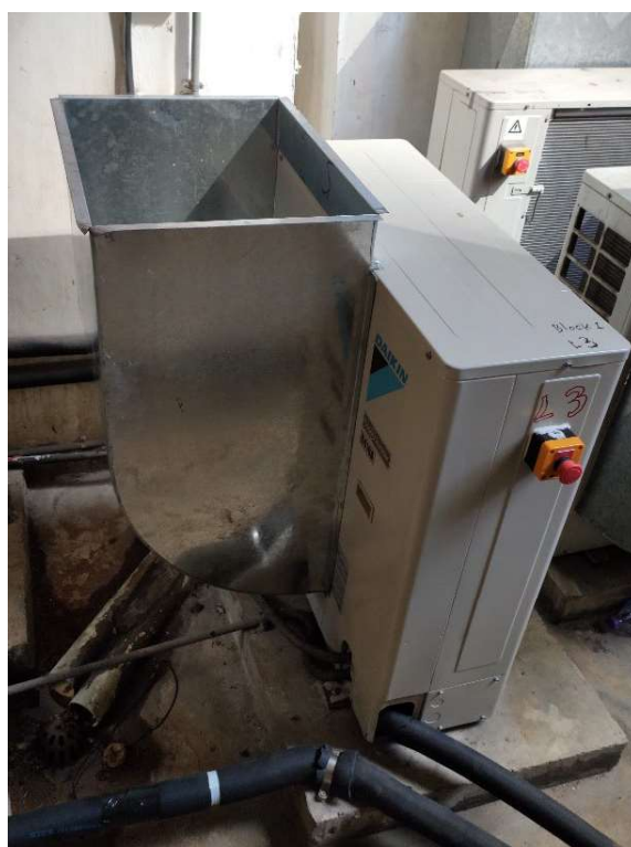
安裝後室外機
