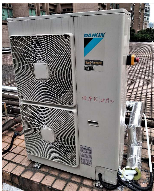
安裝後室外機
