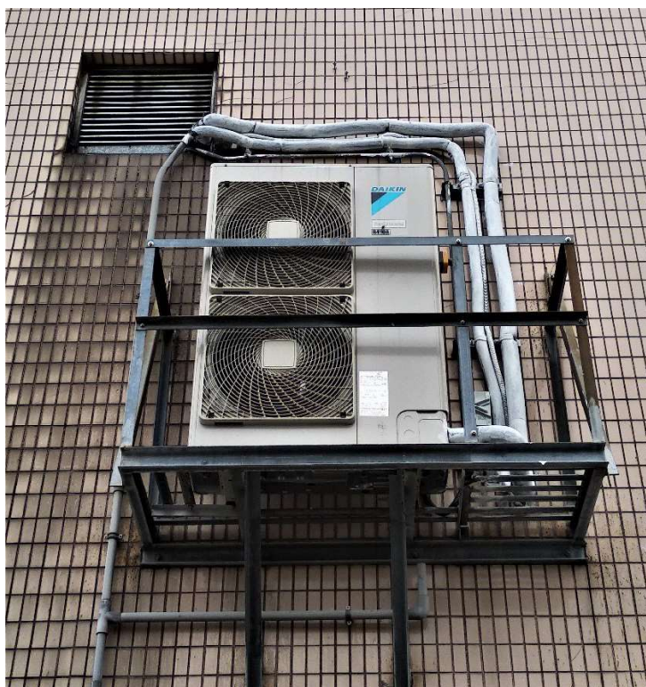
安裝後室外機
