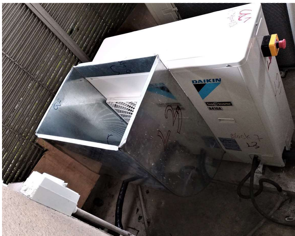
安裝後室外機
