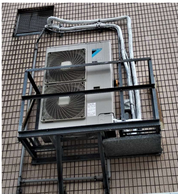
安裝後室外機
