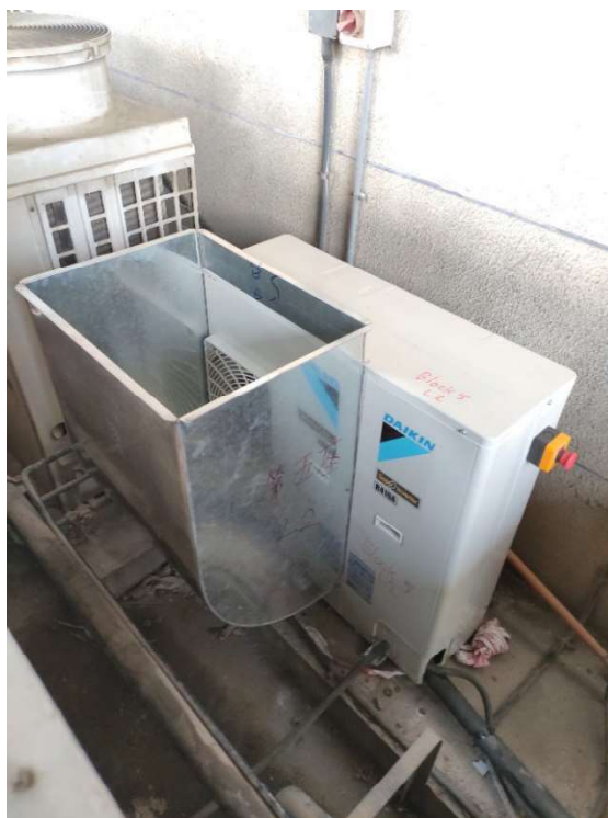
安裝後室外機
