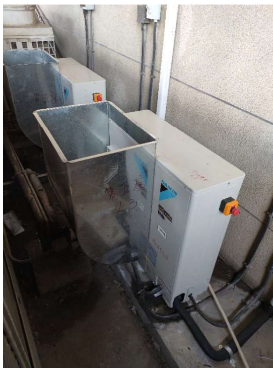
安裝後室外機
