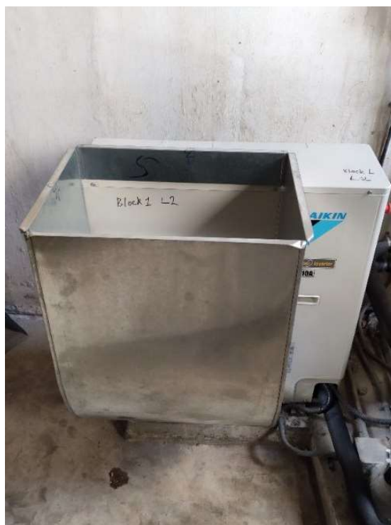
安裝後室外機
