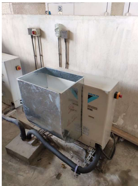
安裝後室外機
