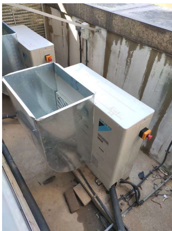
安裝後室外機
